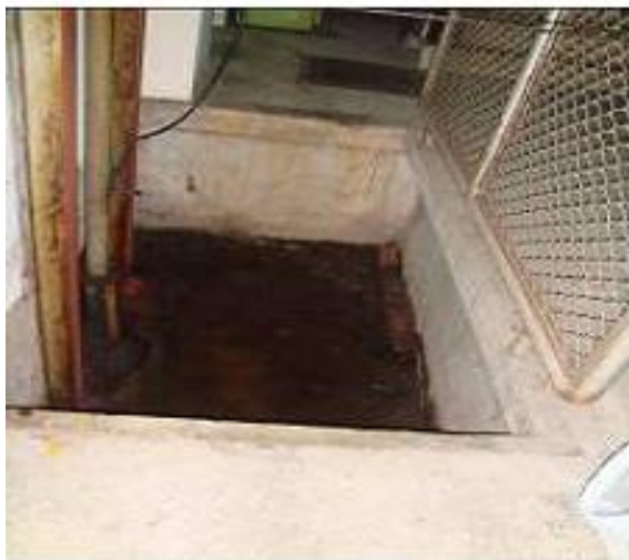
地下室之升降梯孔積水
