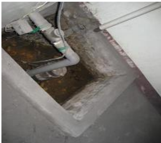
地下室儲水槽
