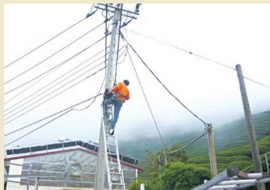
圖五、99年11月辦理中投有線電視補助案完工查核天氣狀況及業者協助查測信號
